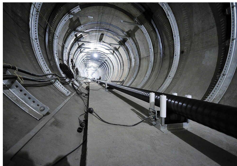
变电站本体为筒形全地下结构
